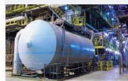
EAUX PROCESS CHIMIE
